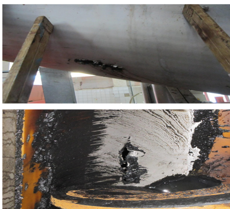
Рис. 14. Износ транспортера обезвоженного осадка.
